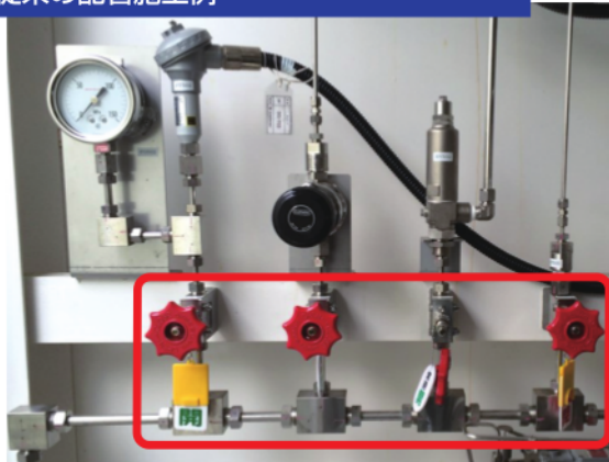
従来の配管施工例
